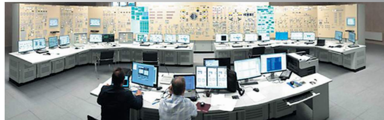
Полномасштабный тренажер PMT-3 третьего энергоблока Ростовской АЭС
